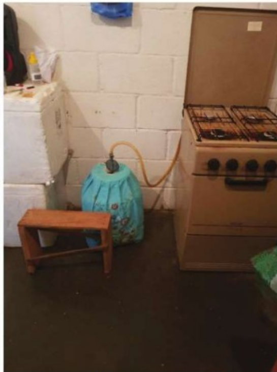
Foto 10: cozinha no alojamento da Fazenda Pedreira, com recipiente de armazenagem de gás liquefeito de petróleo – GLP instalado em área interna, com coordenadas geográficas 21°33'8''S 46°21'58''O.
