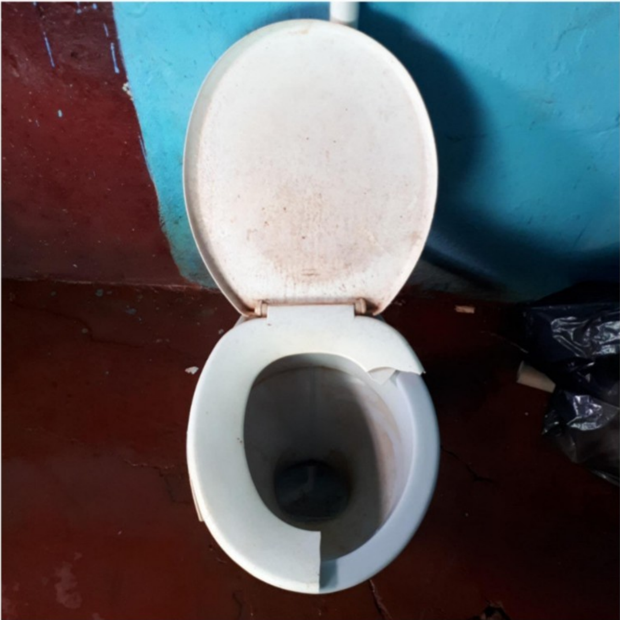
Condições do vaso sanitário e higiene no mesmo banheiro
