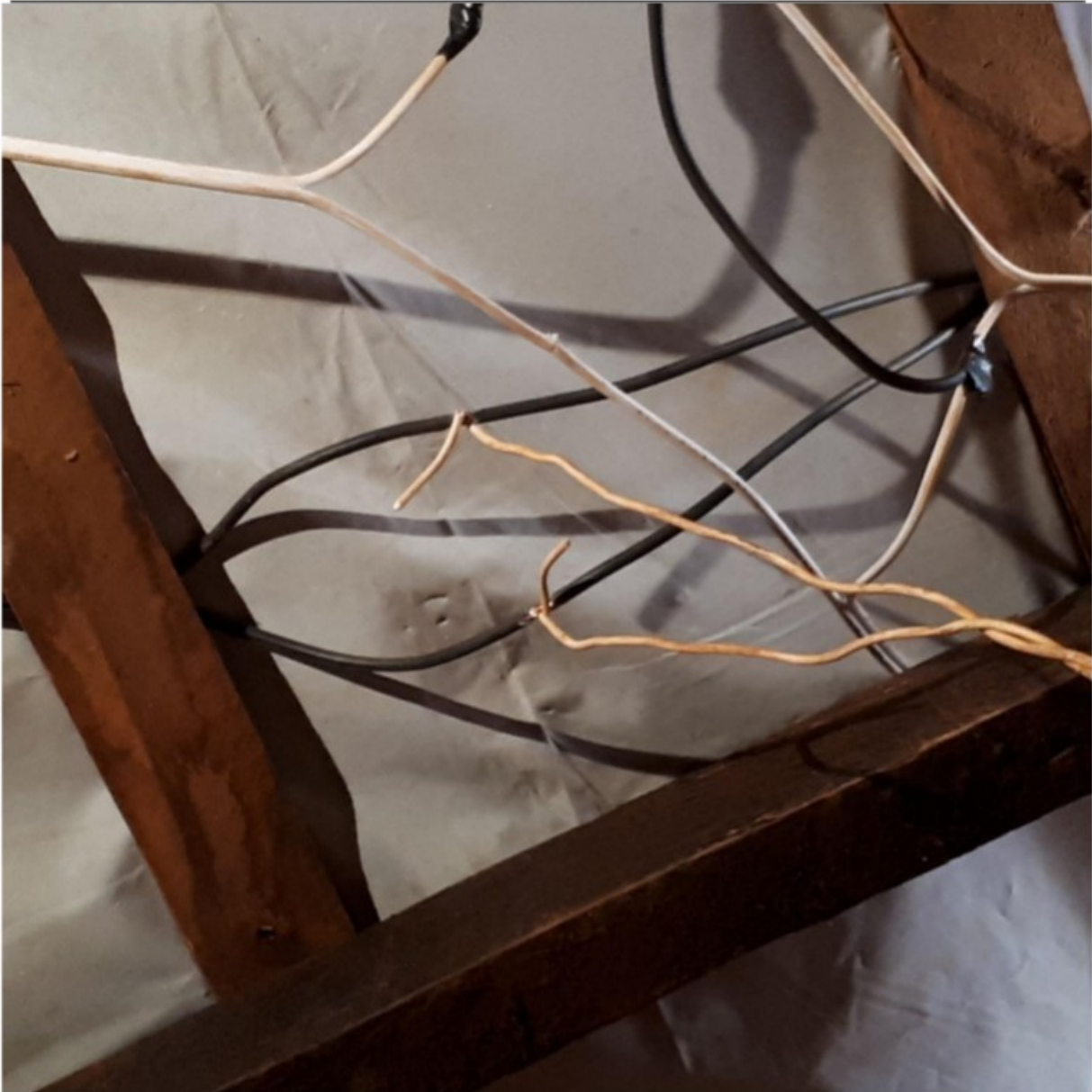
Condições das instalações elétricas na casa com fios soltos e sujeitos a curtos
