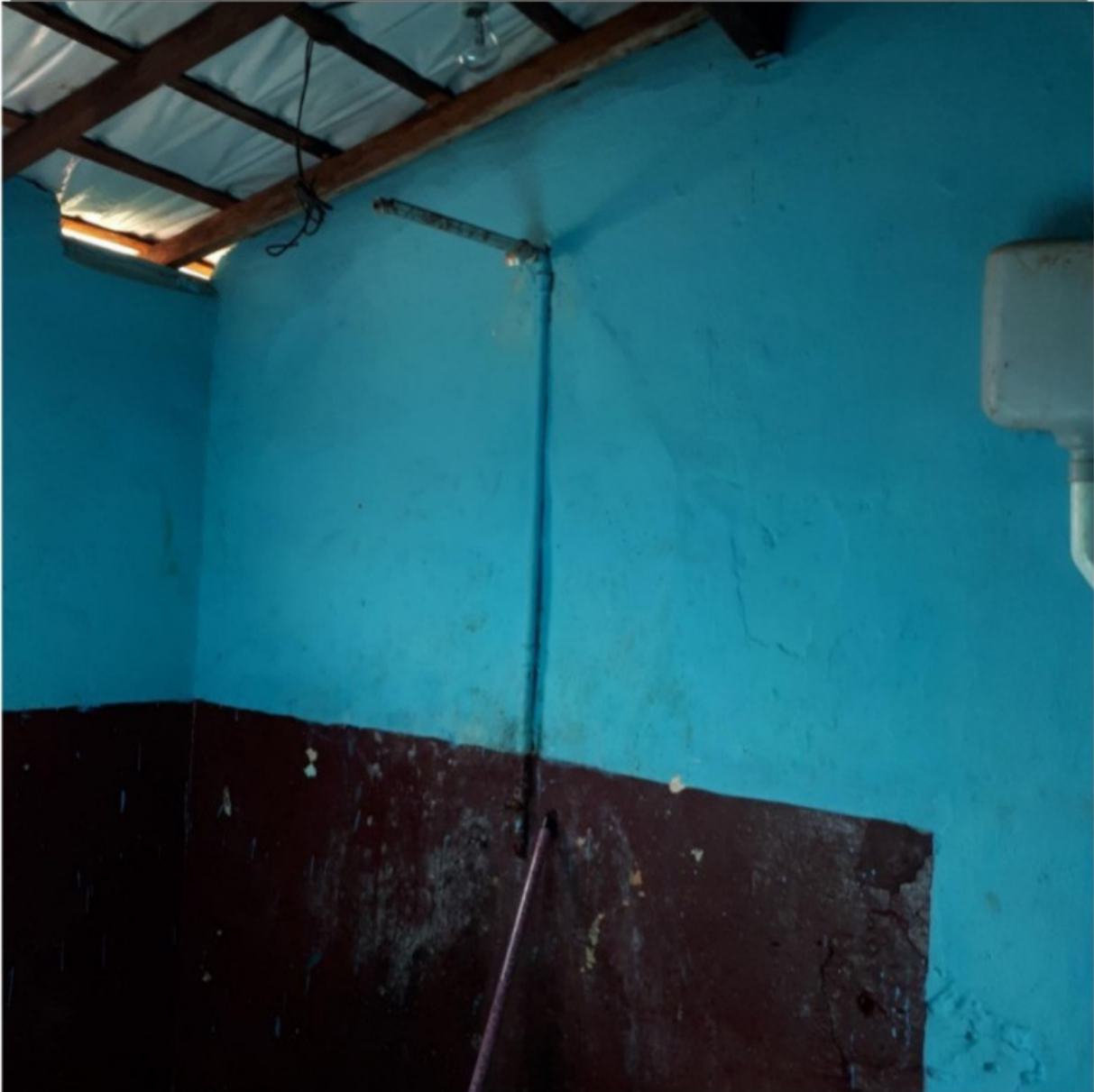
Saída de água do banheiro utilizada pelos trabalhadores como chuveiro
