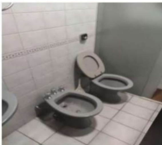
Foto 16: Instalações sanitárias limpas e higienizadas.
