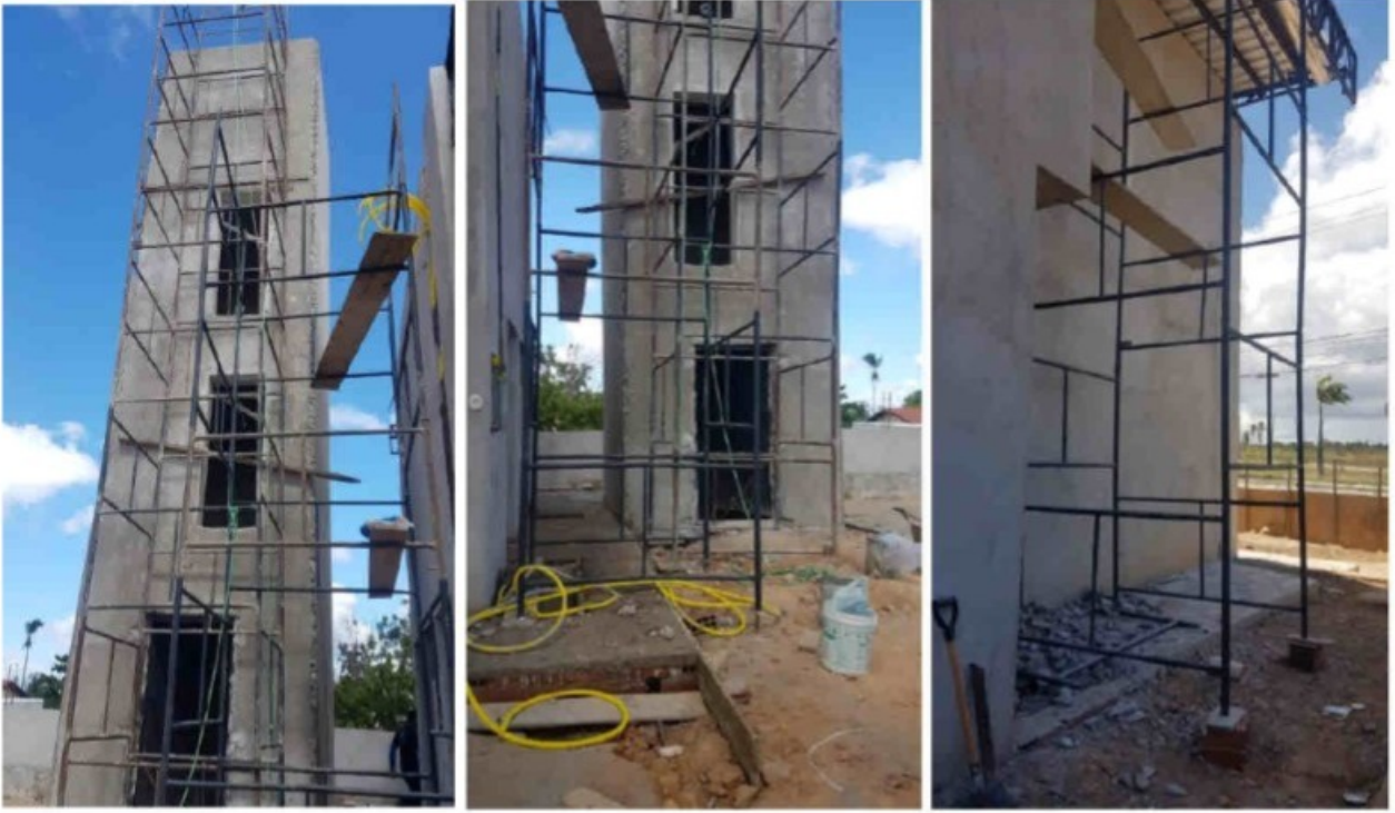
Figuras 31 a 33 Andaimos antes da fiscalização.
