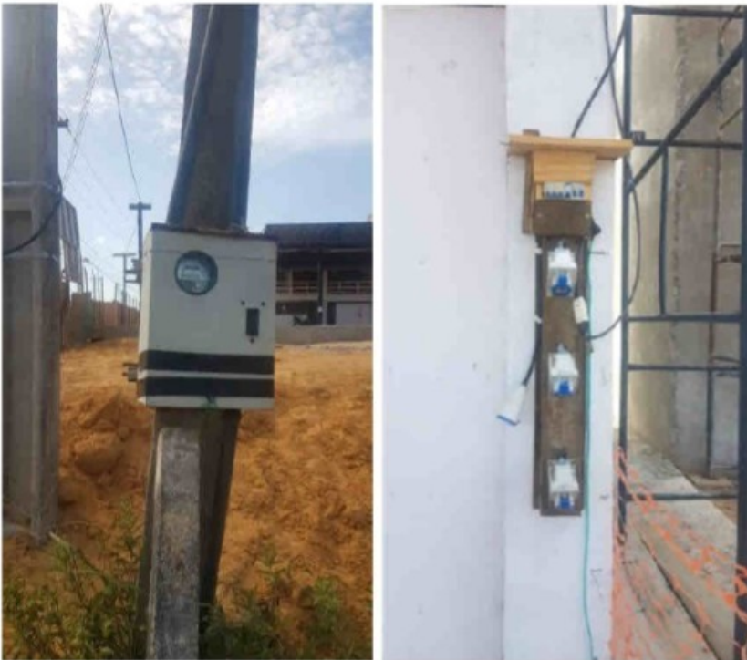
Figuras 39 e 40 Situação após as medidas corretivas.
