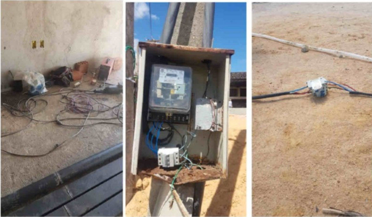
Figuras 36 a 38 Riscos de choque elétricos. Situação encontrada pela fiscalização na primeira visita ao canteiro.
