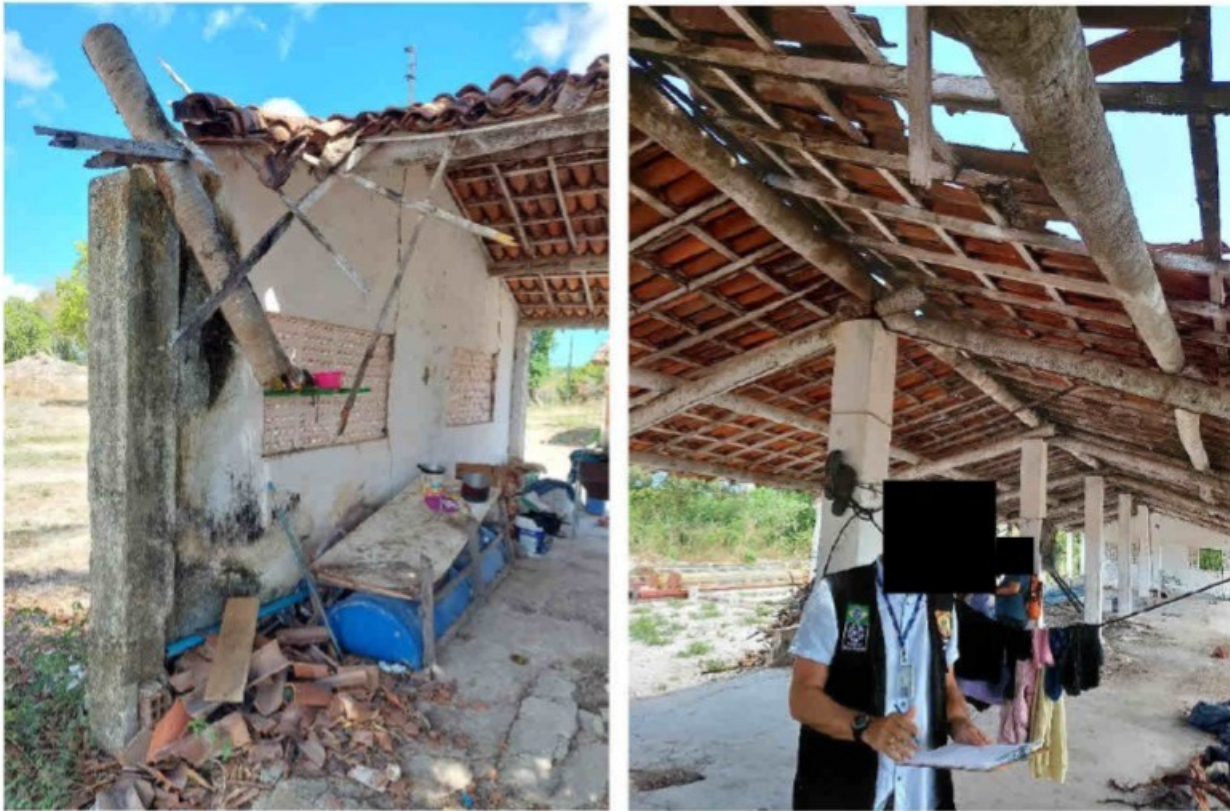
Figura 16 a 19 Detalhes do telhado com risco iminente a saúde e segurança dos trabalhadores alojados.
