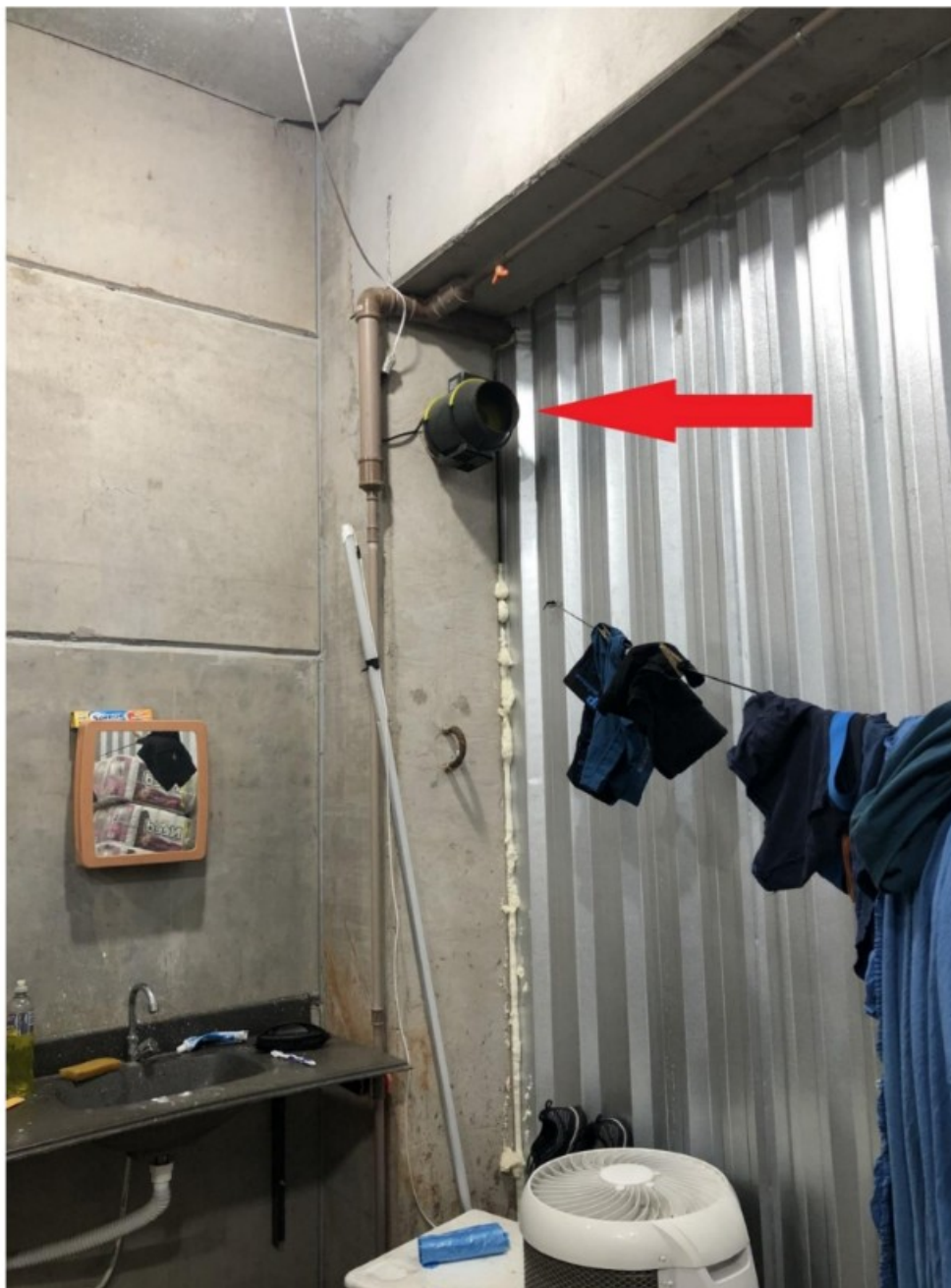
Foto 8 - Exemplo de exaustor de ar existente no local.
