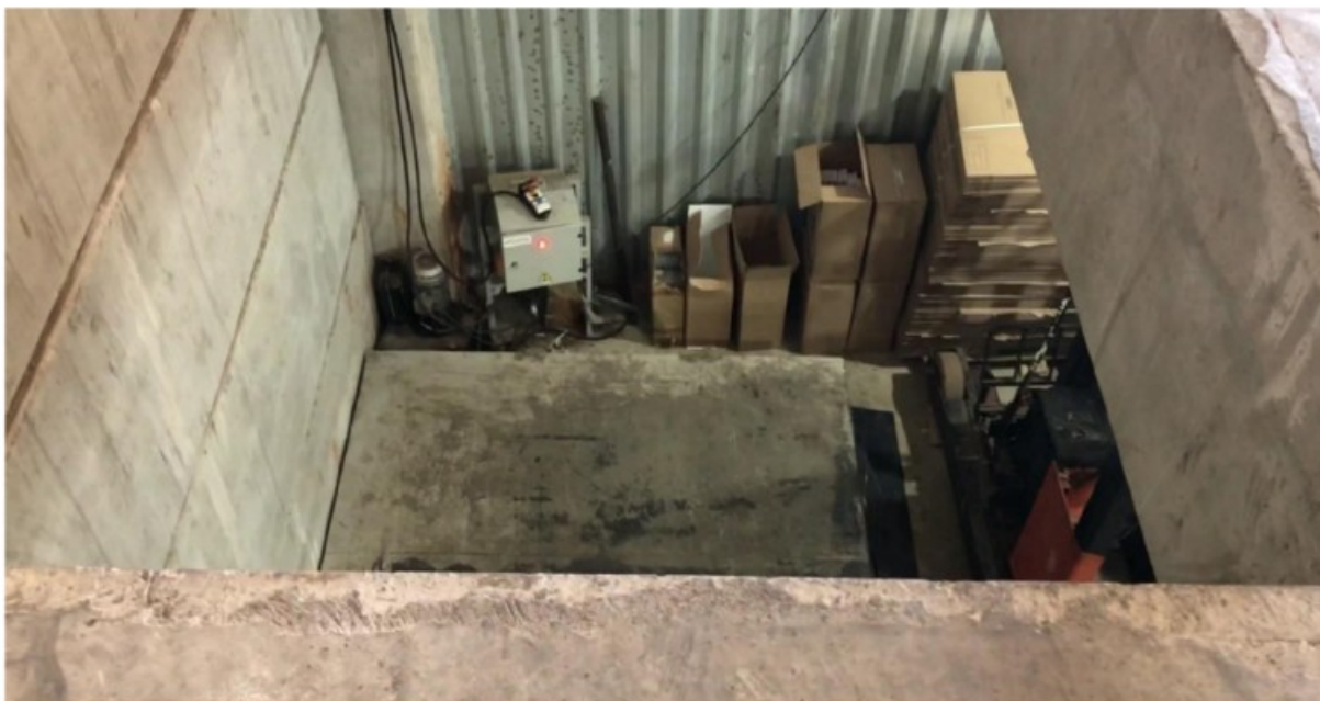
Foto 4 - Elevador na posição mais baixa, revelando a fábrica clandestina de cigarros e alojamento dos trabalhadores.
