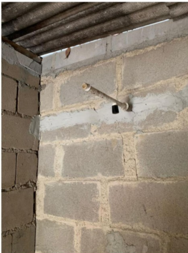
DETALHE DO "CHUVEIRO"EXISTENTE NO ALOJAMENTO
