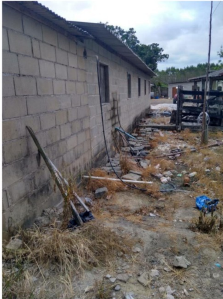
DETALHE DA ÁREA EXTERNA AO ALOJAMENTO. ESGOTAMENTO SEM FOSSA
