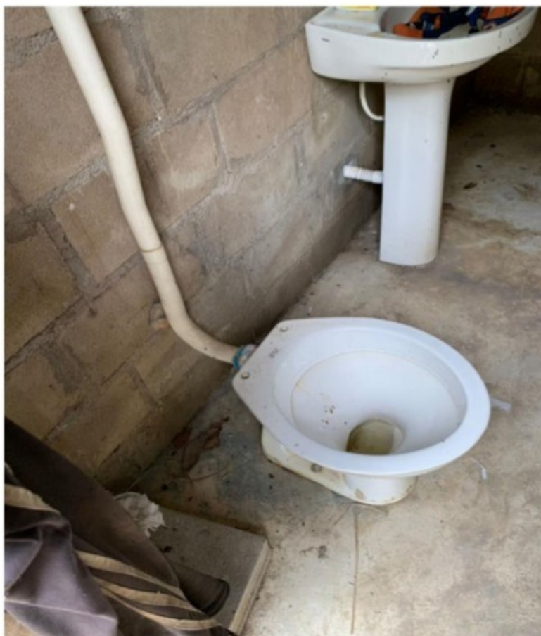
INSTALAÇÃO SANITÁRIA PRECÁRIA NO INTERIOR DO ALOJAMENTO
