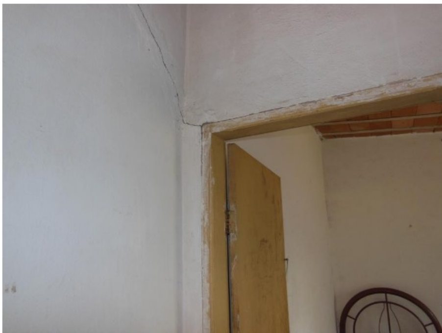
Figura 10 – Ainda na Casa 2, rachadura na parede do corredor, sobre o batente da porta do segundo dormitório. Fotografia feita pela fiscalização em 24/08/2021.
