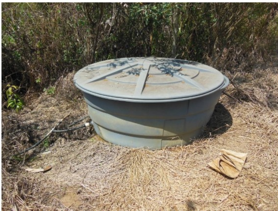
Figura 23 – Caixa de acumulação da água coletada na nascente, entre a nascente e as edificações utilizadas como alojamento. Fotografia feita pela fiscalização em 24/08/2021
