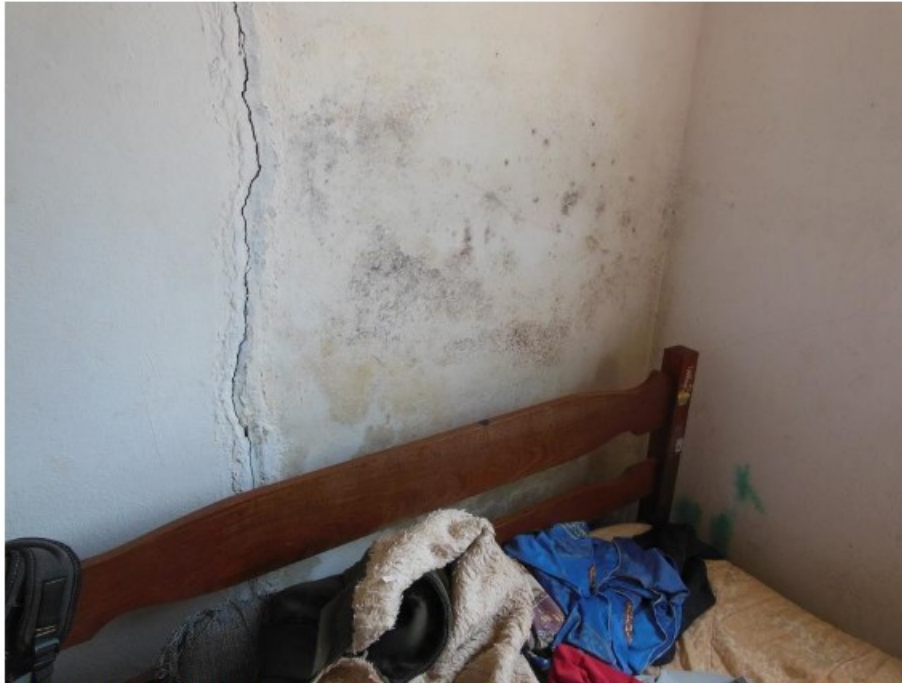
Figura 8 – Ainda no mesmo cômodo, pode-se observar parede mofada atrás da cabeceira da cama dos trabalhadores. Fotografia feita pela fiscalização em 24/08/2021.
