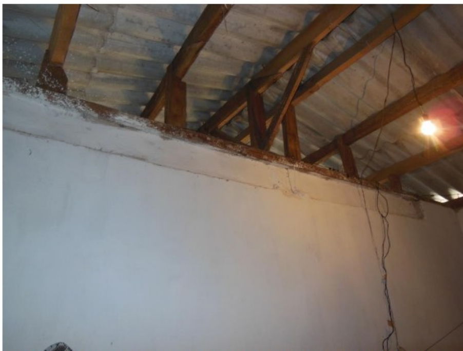
Figura 16 – Telhado de telhas de amianto na Casa 1, sem forro e com frestas nas laterais. Fotografia feita pela fiscalização em 24/08/2021.
