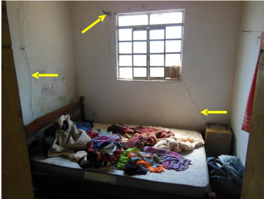
Figura 6 – Dormitório do casal, na Casa 2. As setas apontam rachaduras na parede. Fotografia feita pela fiscalização em 24/08/2021.
