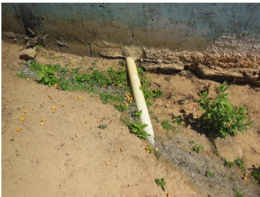
Figura 15 - Cano despejando águas servidas do ralo do banheiro no entorno da Casa 1. Fotografia feita pela fiscalização em 24/08/2021.
