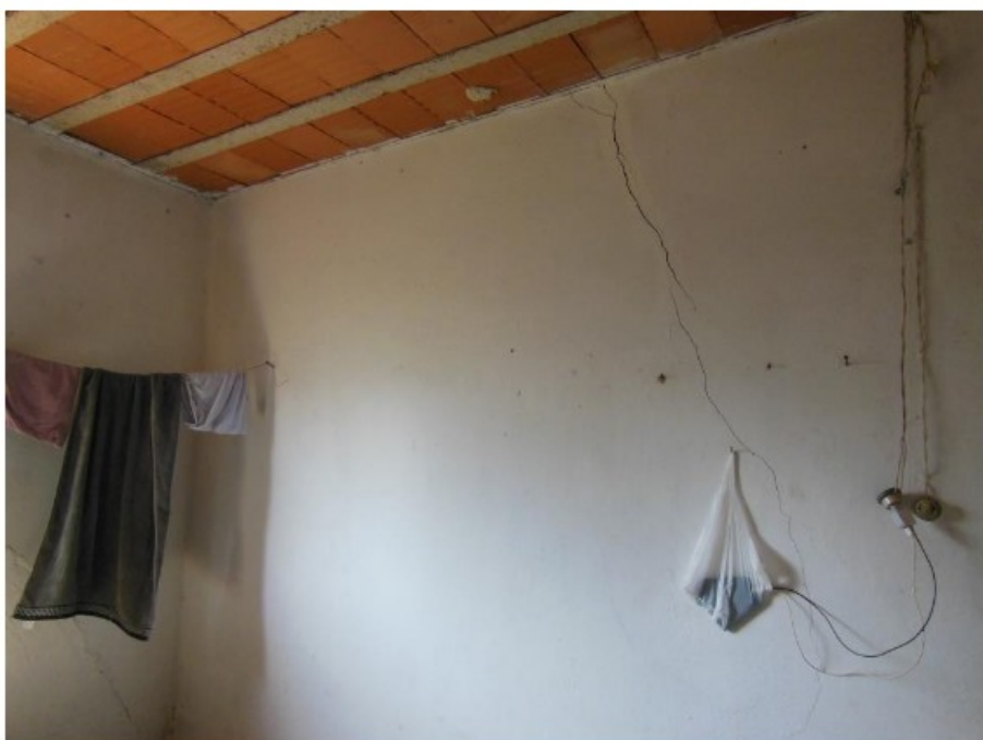
Figura 11 – Rachadura na parede do segundo dormitório. Fotografia feita pela fiscalização em 24/08/2021.
