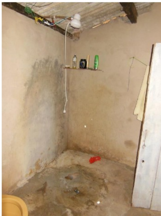
Figura 12 – Banheiro da casa 2. Fotografia feita pela fiscalização em 24/08/2021.
