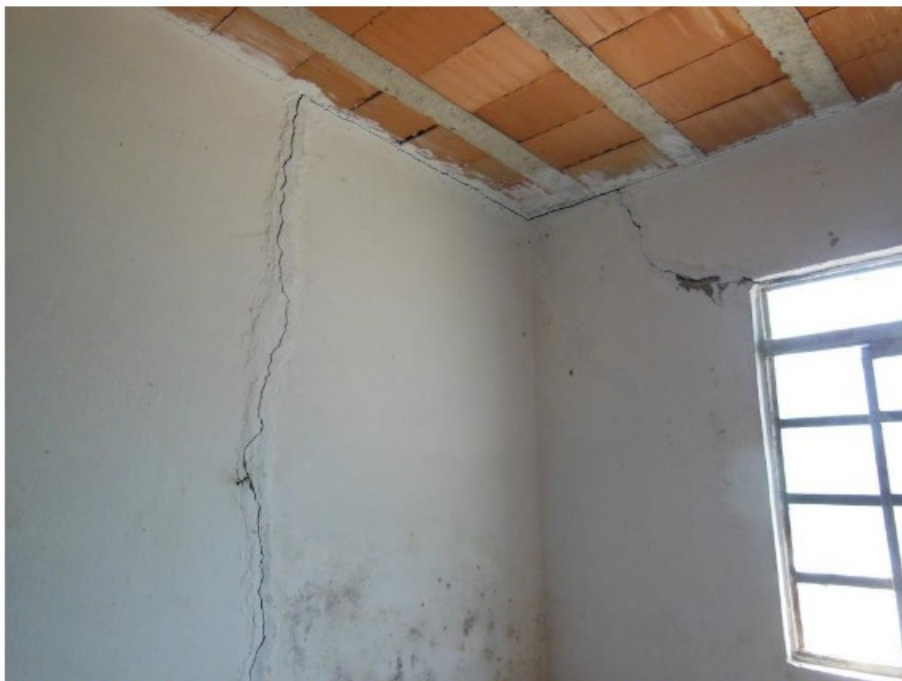
Figura 7 – Mesmo cômodo da figura anterior. Aqui, as rachaduras podem ser vistas com maior nitidez. Fotografia feita pela fiscalização em 24/08/2021.
