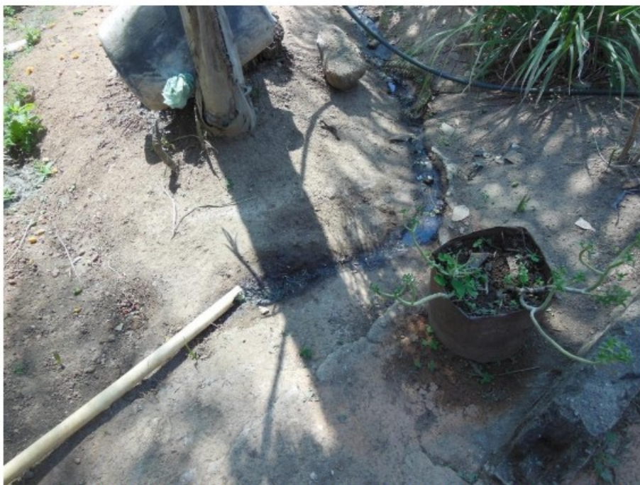
Figura 14 – Cano despejando águas servidas do tanque da cozinha no entorno da Casa 1. Fotografia feita pela fiscalização em 24/08/2021.
