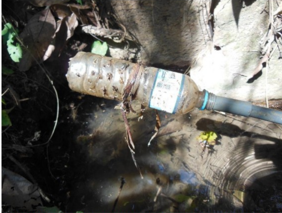
Figura 20 – Na extremidade do mesmo tubo de pvc mostrado na figura anterior, encontramos garrafa plástica perfurada, utilizada em captações precárias para impedir o entupimento do tubo. Fotografia feita pela fiscalização em 24/08/2021.
