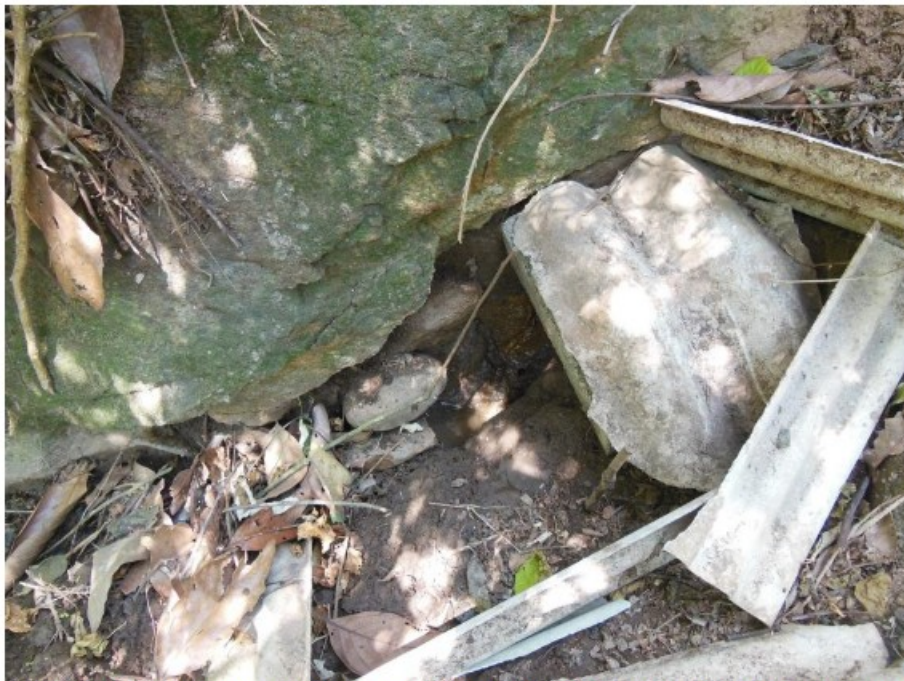
Figura 21 – A outra extremidade, de um segundo tubo de pvc, foi encontrada sob pedras e cacos de telhas de amianto, ao lado da poça mostrada nas figuras anteriores. Fotografia feita pela fiscalização em 24/08/2021.
