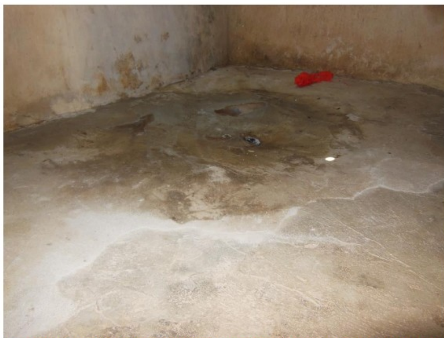
Figura 13 – Detalhe do piso do banheiro, irregular e desnivelado. Fotografia feita pela fiscalização em 24/08/2021.
