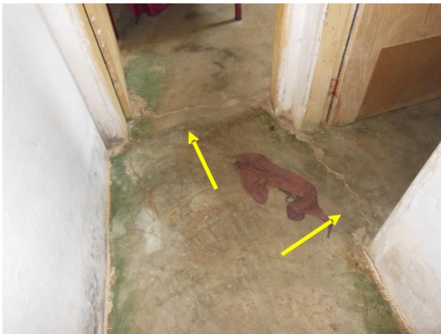
Figura 9 – Na mesma casa, entre o banheiro e o segundo dormitório, as setas apontam rachaduras no piso. Fotografia feita pela fiscalização em 24/08/2021.
