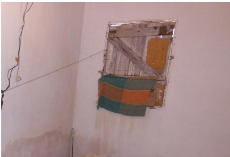
Figura 17 – Janela do dormitório da Casa 1, com pedaços de madeira e pano cobrindo buracos. Fotografia feita pela fiscalização em 24/08/2021.
