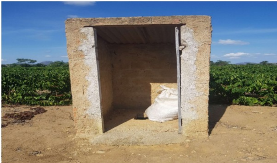
Figura 2: estrutura inacabada e inutilizada citada acima
