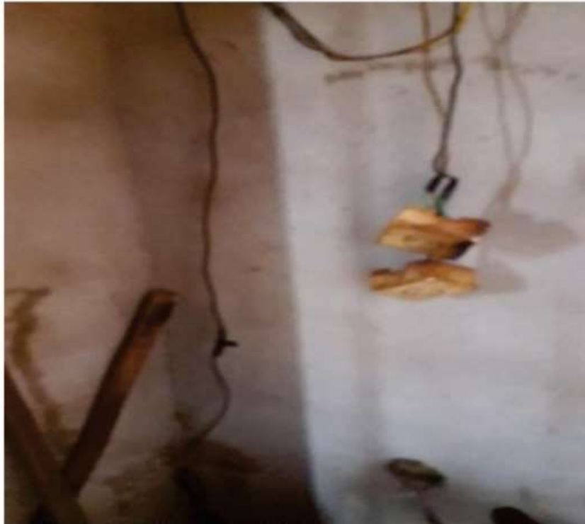
Foto 8: Ausência de energia elétrica
