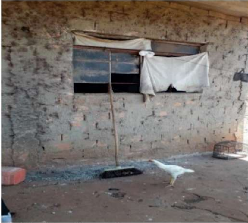
Foto 6: Janela com vidro quebrado
