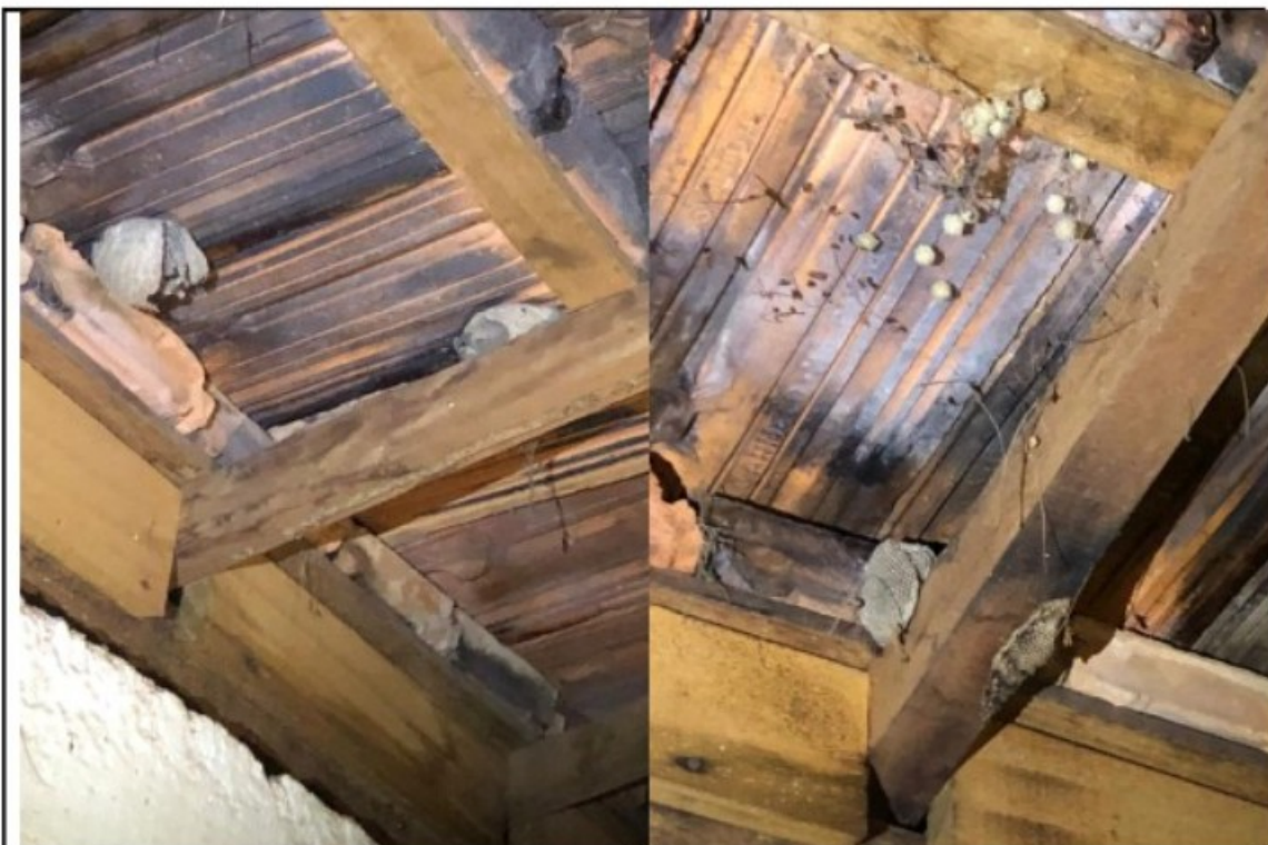
Figura 4 ninho de marimbondos no teto da residência
