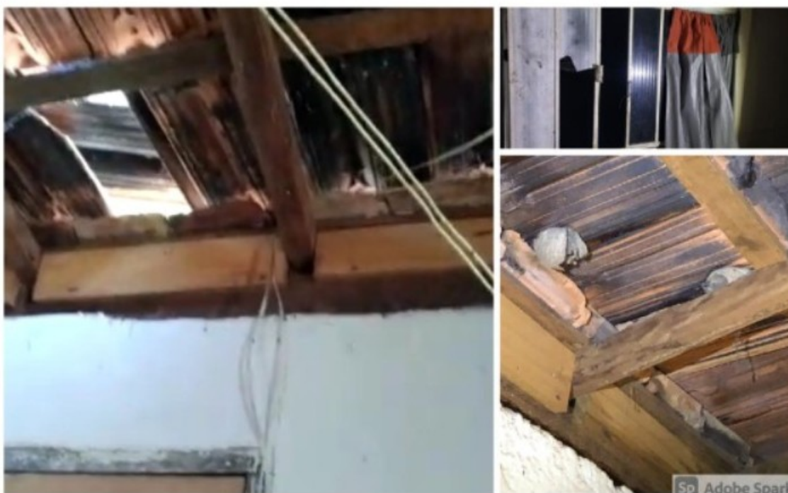
Figura 3 a primeira imagem ilustra uma abertura no telhado, extraída do vídeo enviado pelo trabalhador. A segunda retrata a janela quebrada de um dos quartos; a terceira a presença de um ninho de marimbondo no interior da edificação.
