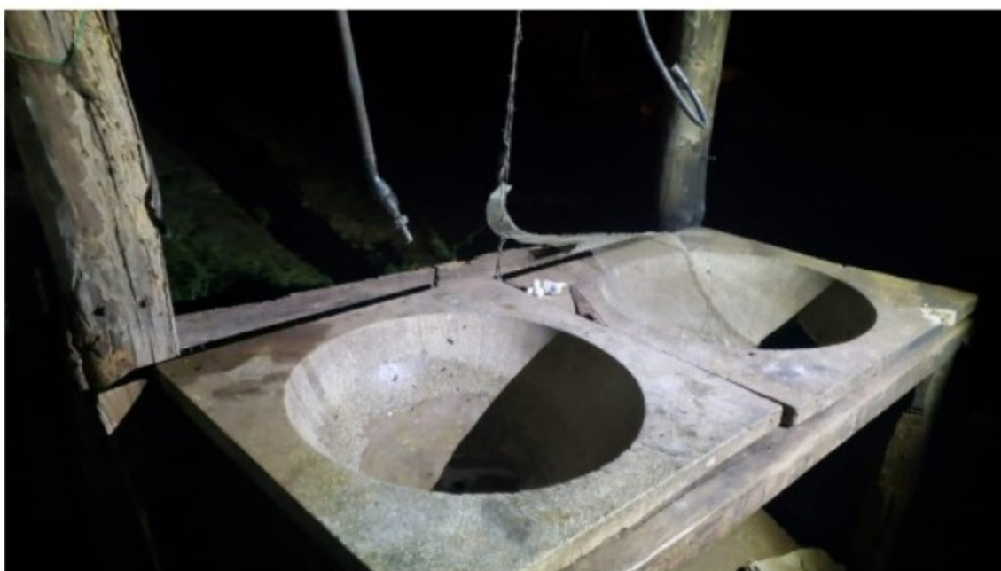
Figura 11 lavanderia em condições precárias
