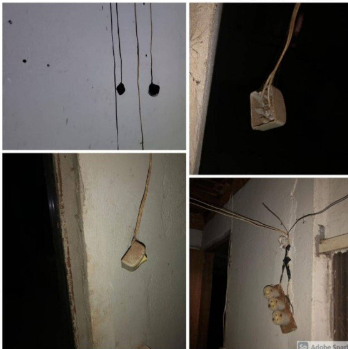
Figura 10 fiação improvisada e exposta
