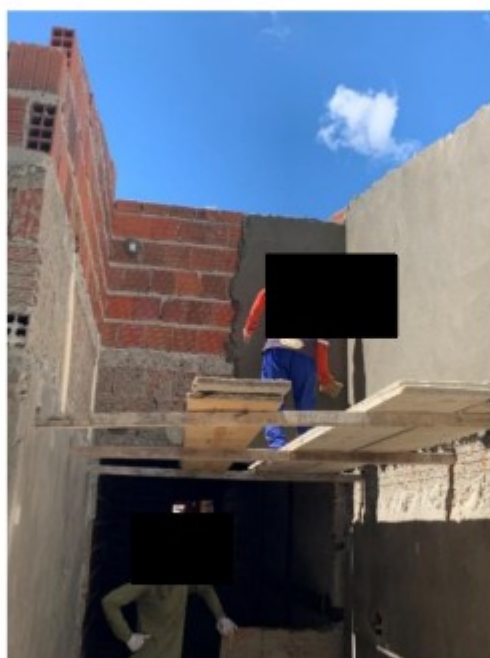
Figura 16: Risco de queda - trabalho em altura sem proteção.
