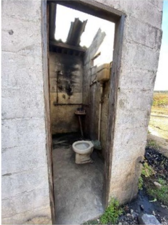
Foto 8: Banheiro sem proteção contra intempéries, sem telhado
