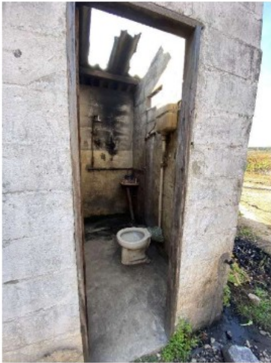
Foto 8: Banheiro sem proteção contra intempéries, sem telhado
