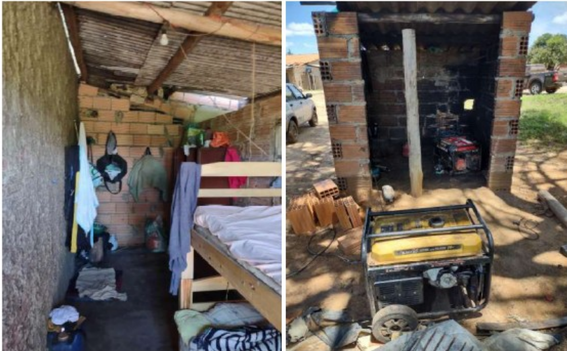
Figura 12: Fiação exposta dentro de um quarto; Figura 13: gerador utilizado na fazenda.
