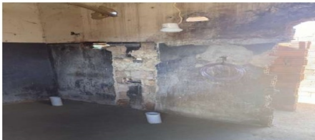
Figura 1 – Banheiro sem condições de uso, descrito acima
