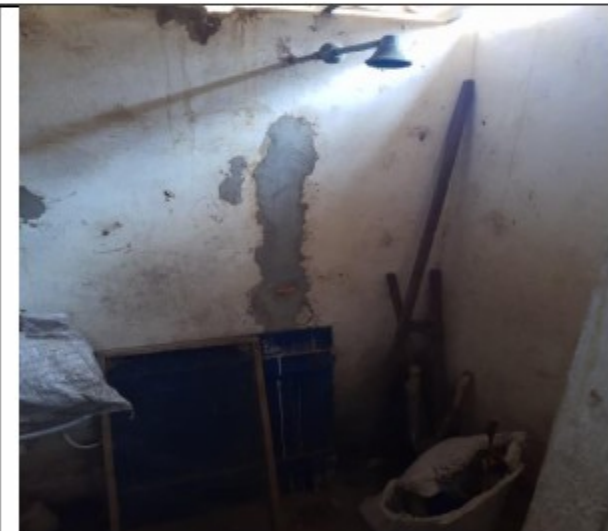
Instalação sanitária inutilizada
