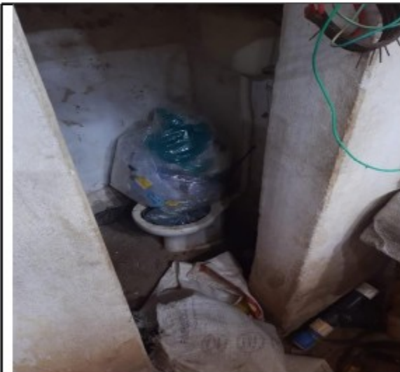
Instalação sanitária inutilizada
