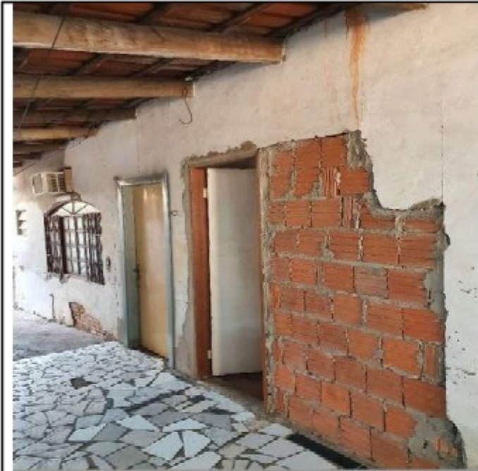
Foto: Porta branca que dá acesso ao cômodo onde empregada doméstica dormia.
