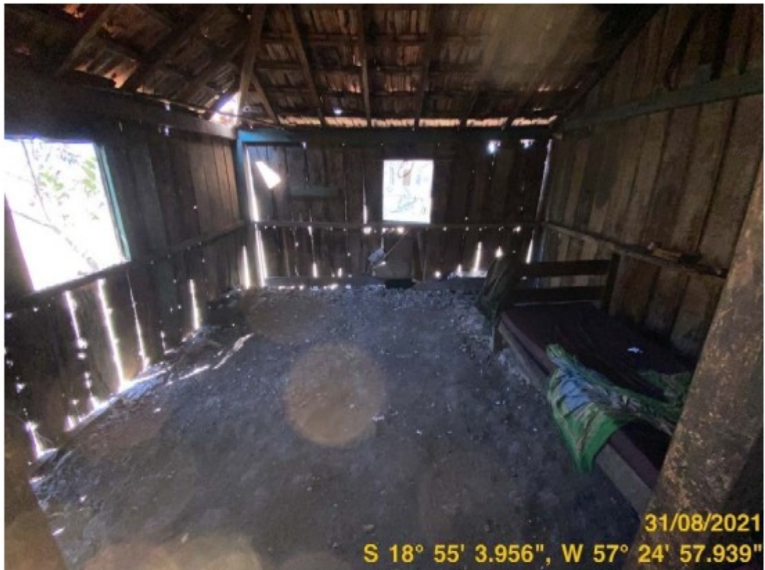
Foto 04: Dormitório na Faz Baía do Cambará (piso de chão batido e paredes com frestas)
