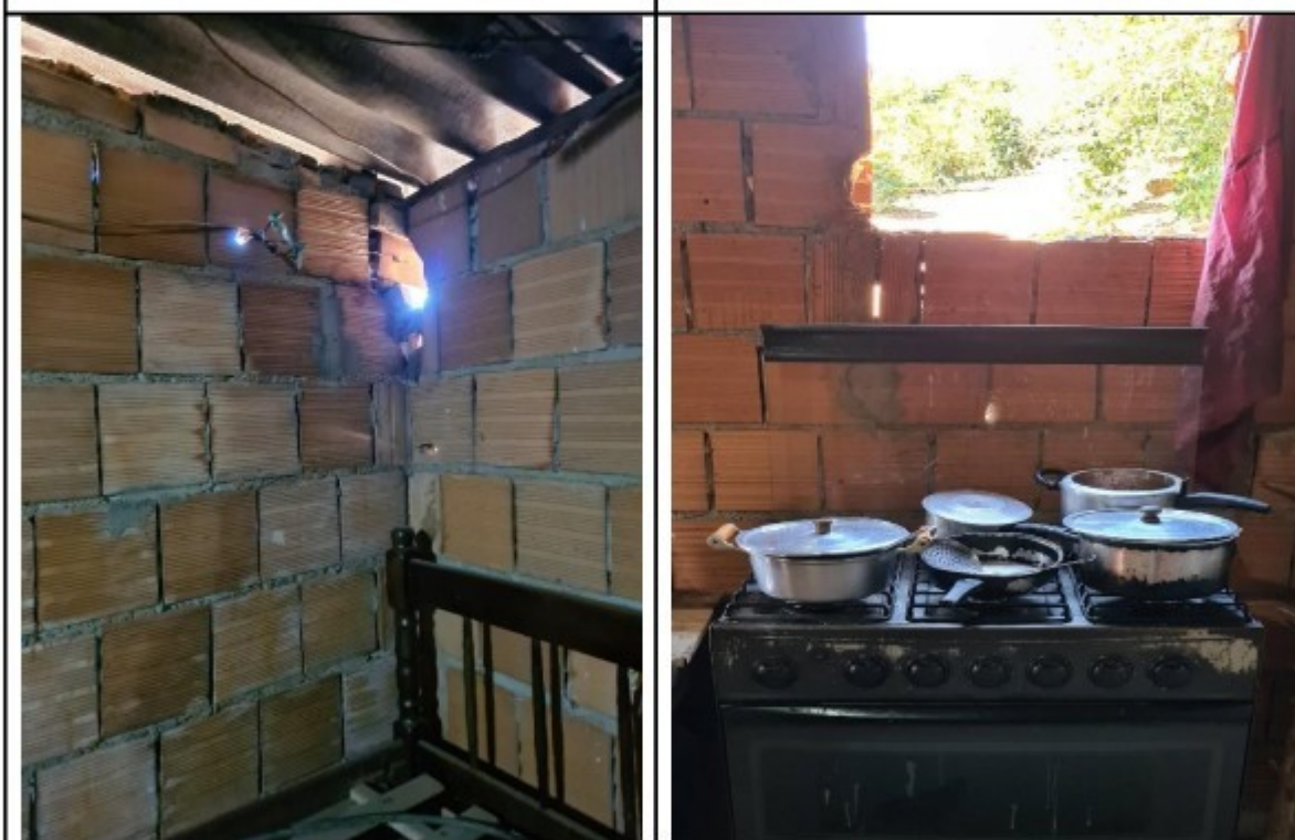
Fotos: Vistas internas do alojamento. Detalhes para aberturas nos telhados e na parede.
