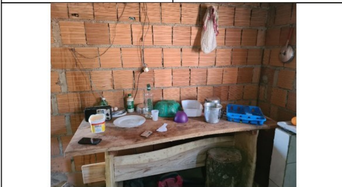
Fotos: detalhes das instalações elétricas improvisadas e com possíveis partes expostas – risco de choque elétrico ou incêndio.
