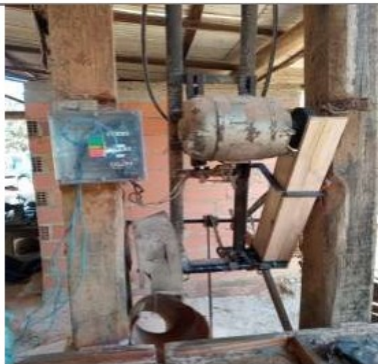
Foto enviada por e-mail após a inspeção no local, mostrando as providências tomadas.
