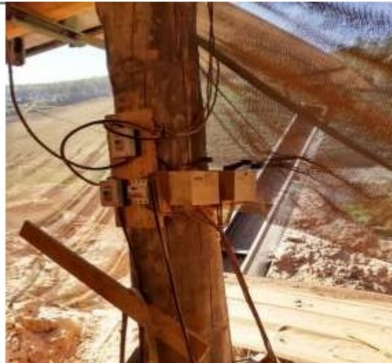
Instalações elétricas irregulares
