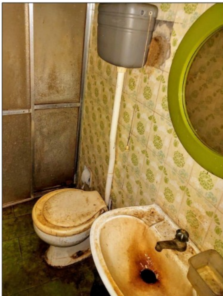
FOTO (04/09/2020): Instalações sanitárias extremamente sujas.
