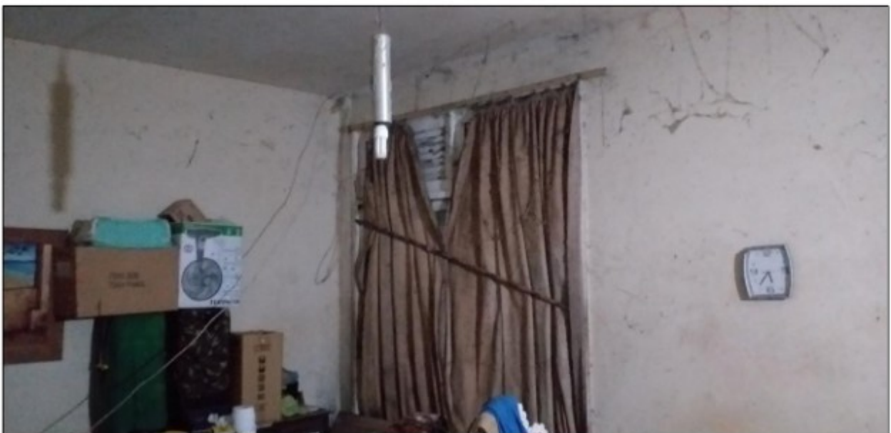
FOTOS (04/09/2020): Dormitório onde estava alojado o trabalhador.
