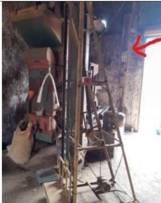
Quadro de energia, com chave tipo faca e lombard, instalado ao lado da máquina de ensacamento do café.
