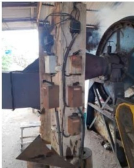
Chaves “lombard” instaladas nas máquinas do processo de secagem do café.
