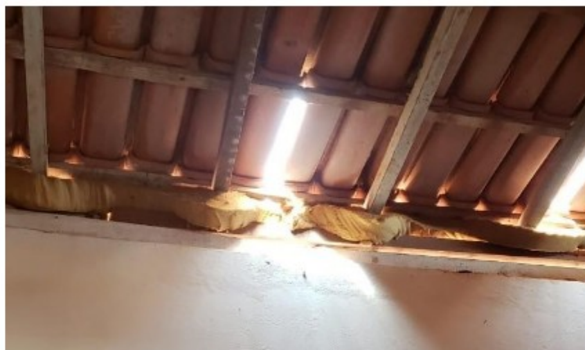
Figura 4: Telhado sem laje, com frestas e telhas quebradas
