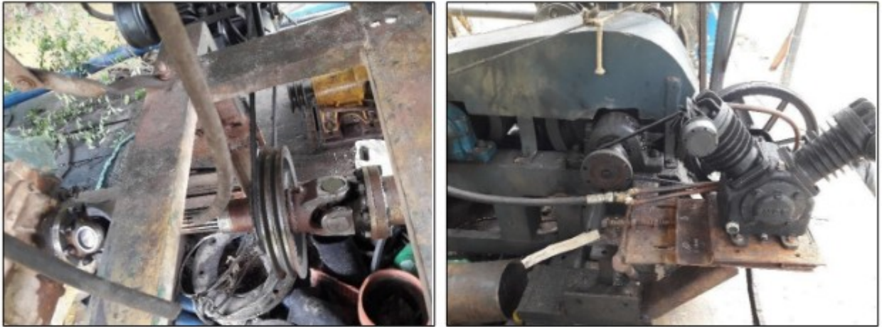
Imagens: Transmissões de força de máquinas expostas.
