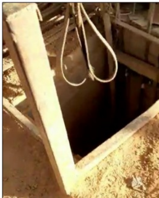
Imagens: Detalhe da abertura do poço da mina, sem qualquer proteção ou sinalização que prevenisse queda de trabalhadores.
