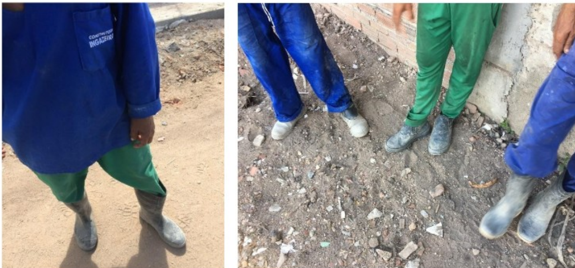
Fotos 5 e 6 – Trabalhadores no local de trabalho (obra de calçamento e pavimentação) com EPIs inadequados para aquela atividade (bota de borracha).
