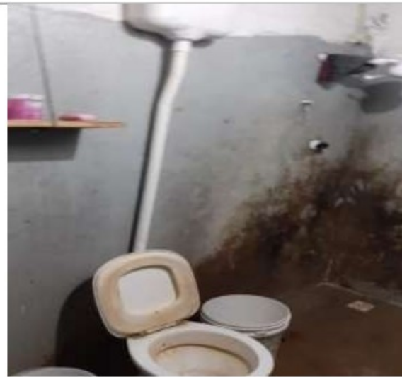
Instalações sanitárias do alojamento
