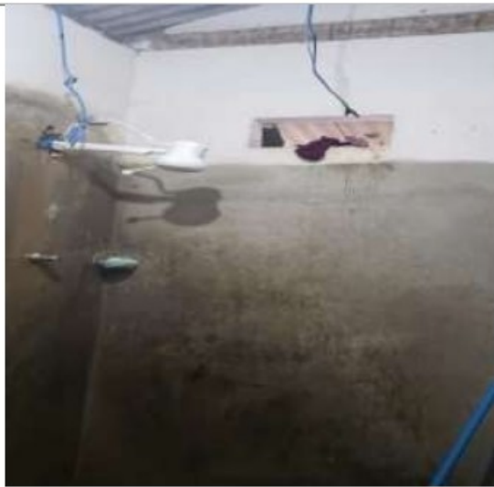
Instalações sanitárias do alojamento
