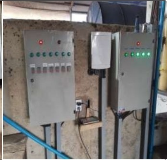
Comandos de acionamento das máquinas
