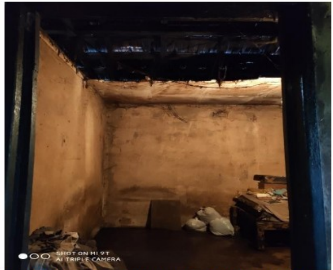
Foto 10: Forro interno do teto quebrado. Chão molhado.
