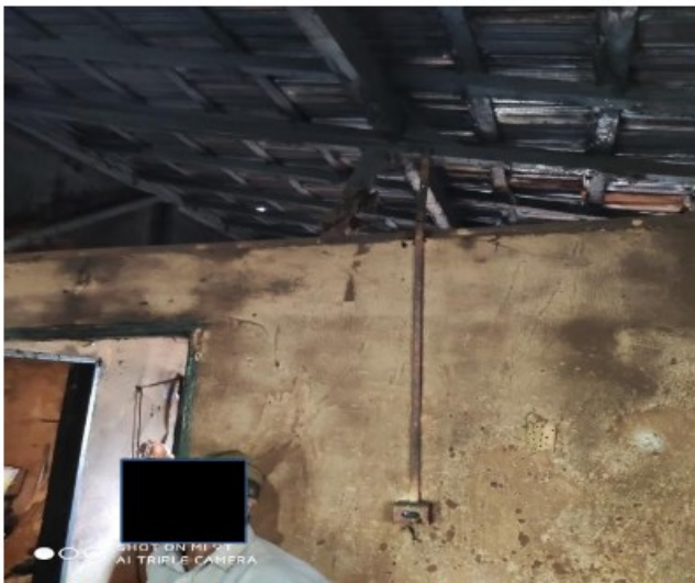
Foto 11: Paredes e teto imundos.
