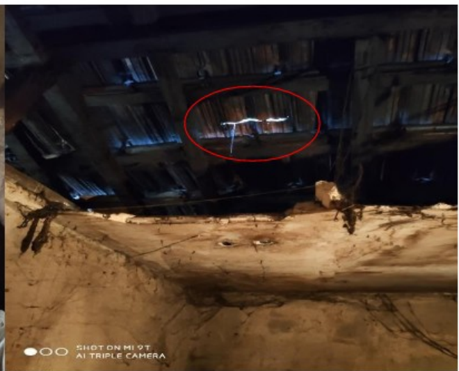
Foto 8: Telha quebrada e infiltração de água da chuva.
