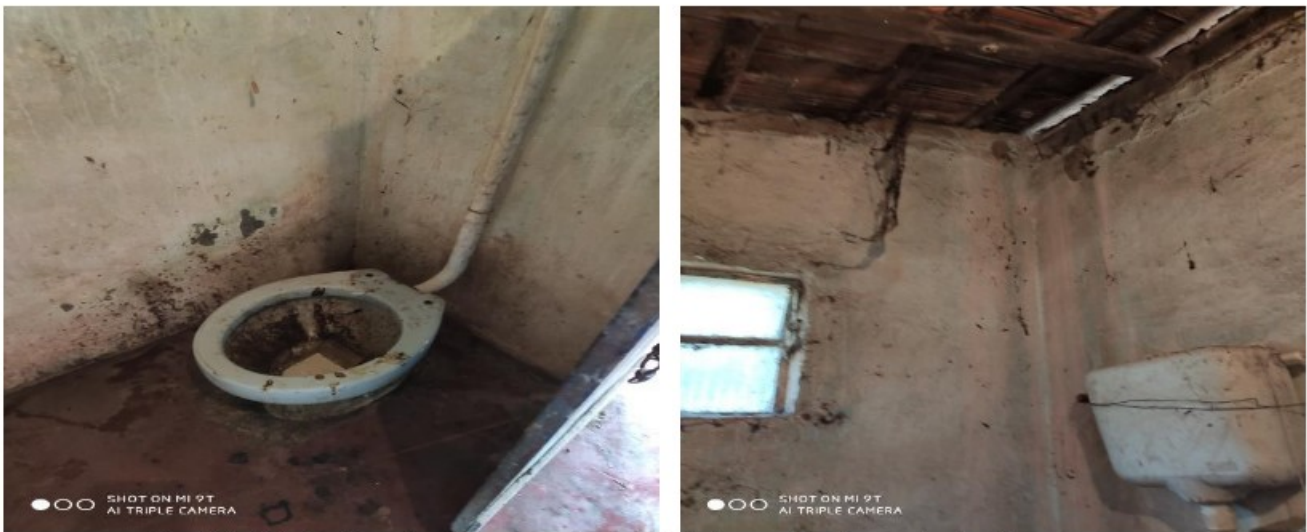
Foto 13 e 14: Péssimas instalações sanitárias. Sujeiras e teias de aranha do chão ao teto.
