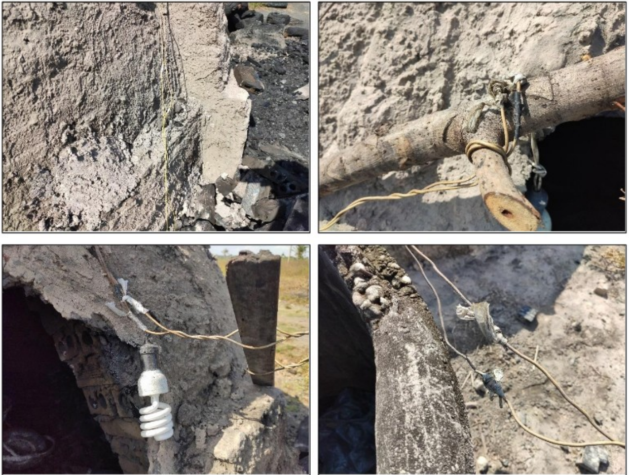
Fotos: Gambiarras encontradas nos fornos de fabricar carvão, com partes vivas expostas com emendas mal protegidas.
