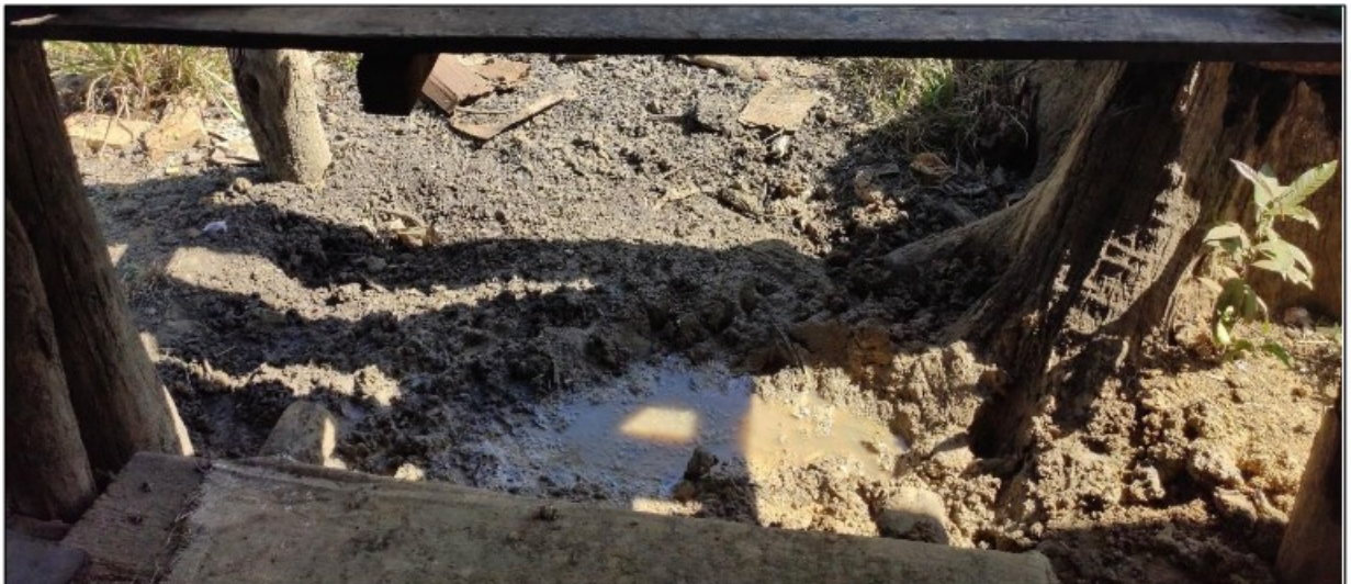
Fotos: Poça de lama que formava com a água que escorria da bancada onde o trabalhador lavava a louça.
