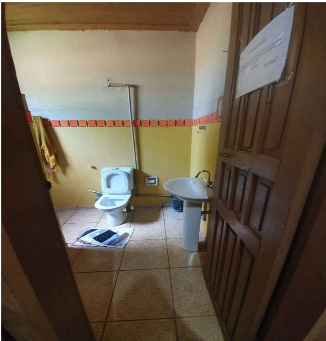
Foto 11. Instalação sanitária do alojamento.
