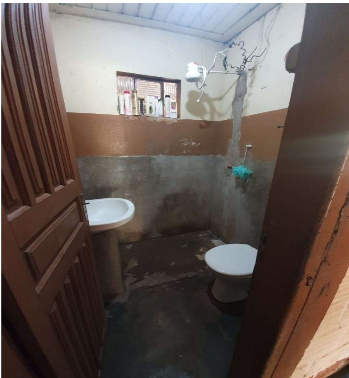
Foto 14. Instalação sanitária no barracão.
