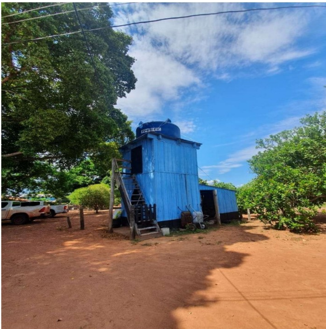
12. Caixa d'água para fornecimento de água.
