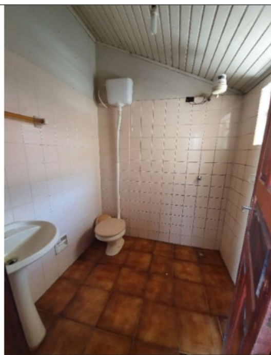
Foto: Instalação Sanitária
