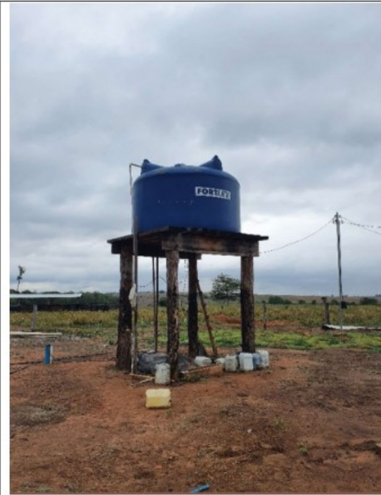
Foto 05: Caixa de condicionamento de água utilizada para consumo
