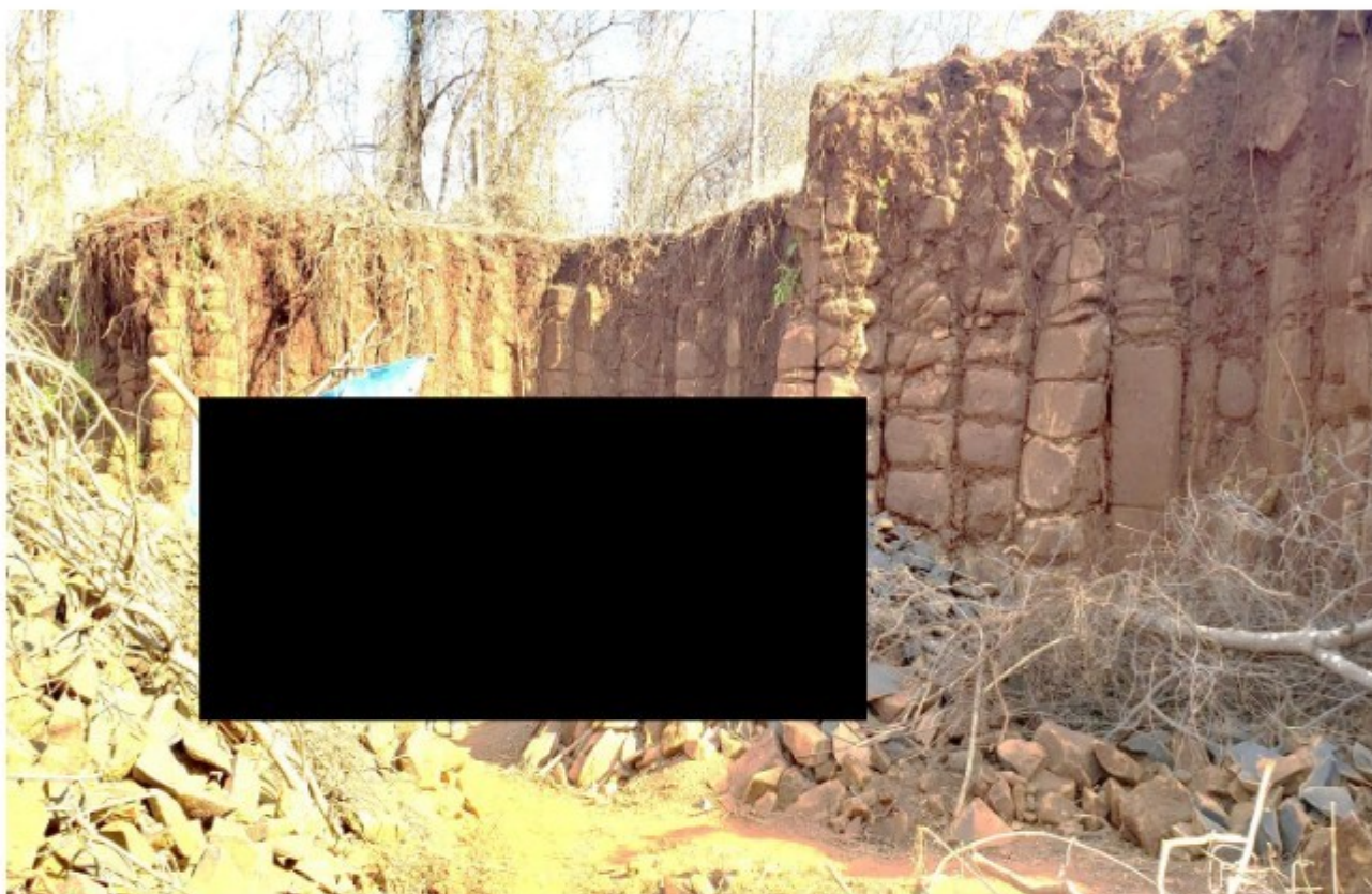
Imagem 14 – Visão geral das bancadas de extração de basalto: risco de queda de rochas soltas sobre os trabalhadores.
