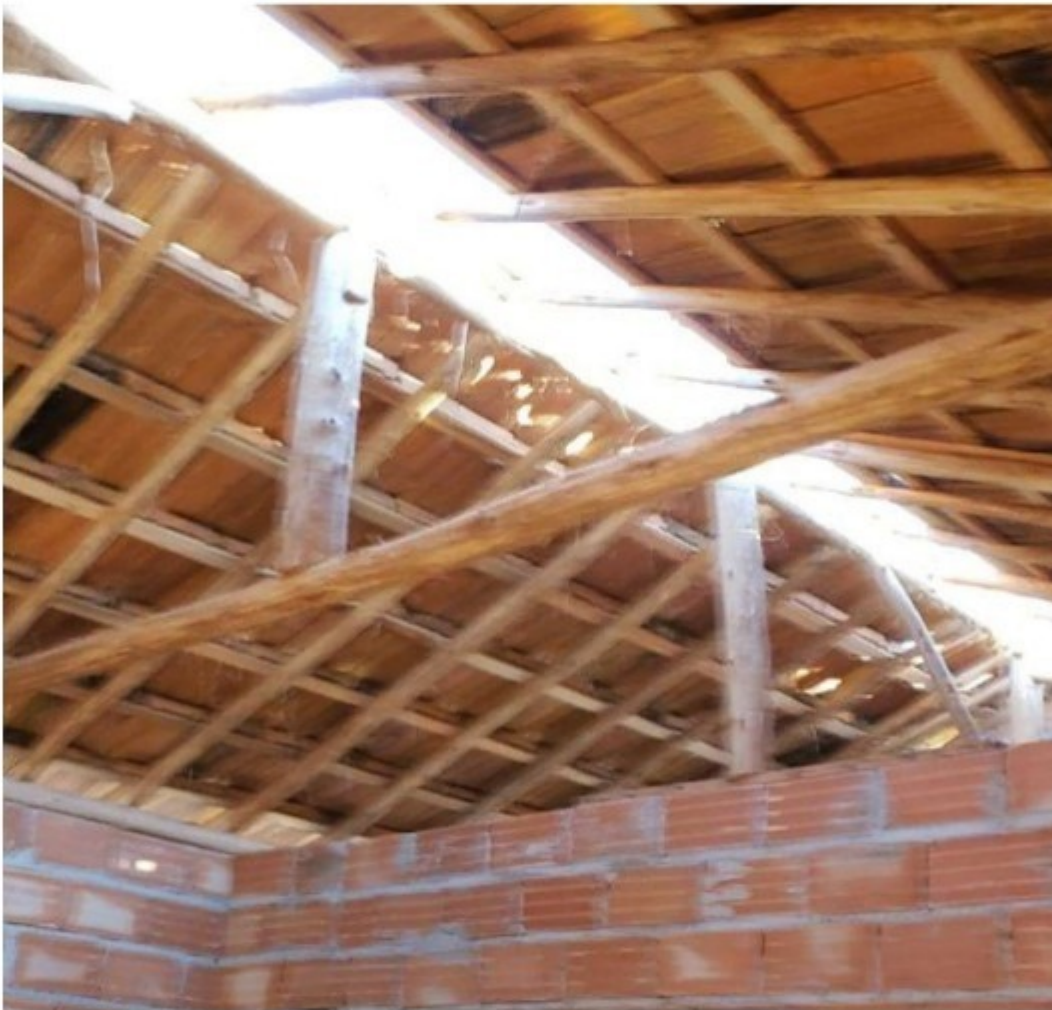
Figura 2: Edificação com paredes rústicas, destituída de forro e com abertura no telhado
