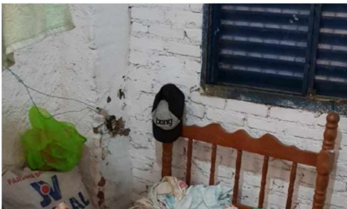
Figura 12: Interruptor improvisado e fiação emendada com fita adesiva
