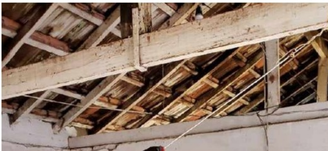
Figura 7: telhado destituído de forro
