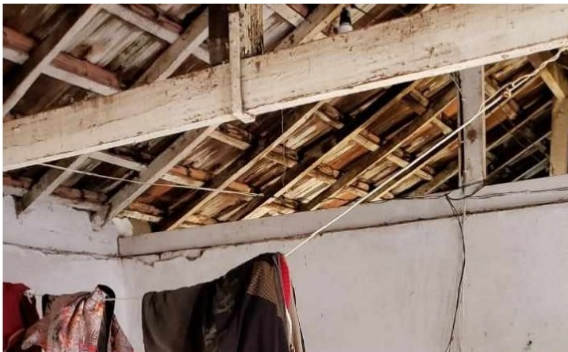
Figura 11: fiação exposta no alojamento
