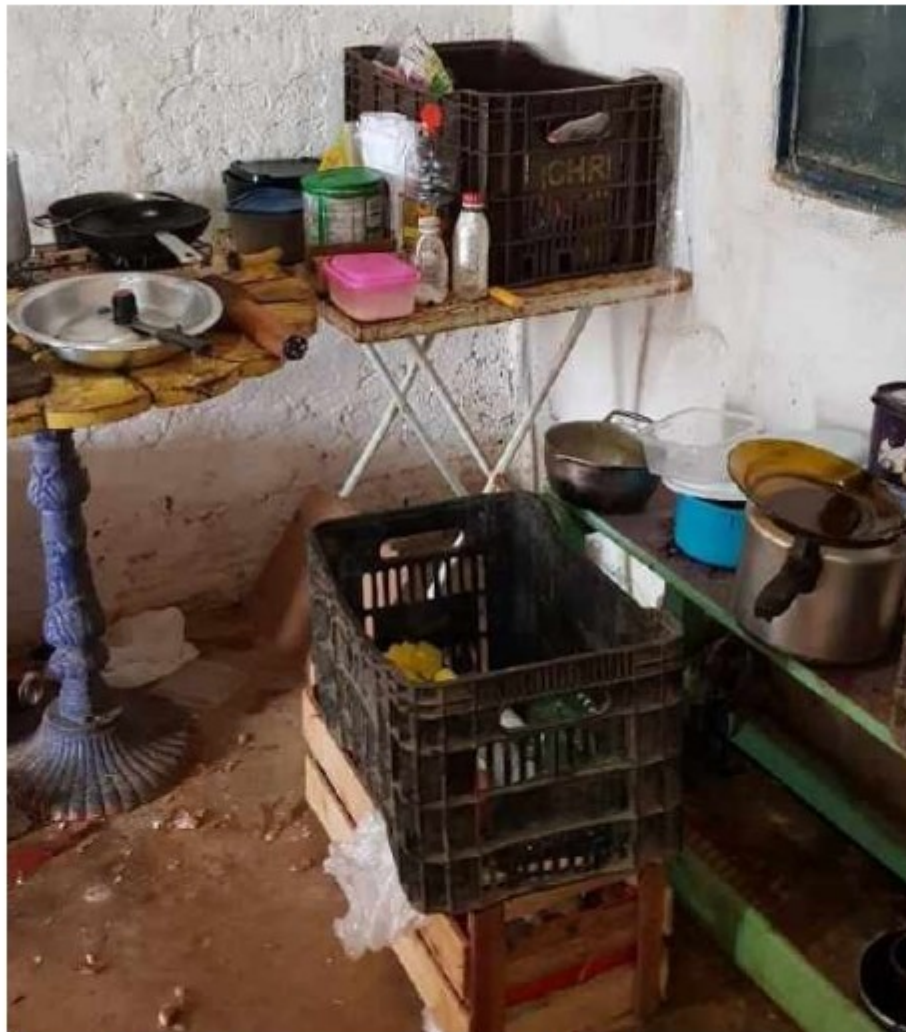
Figura 10: Local para preparo e guarda de alimentos em péssimo estado de conservação
