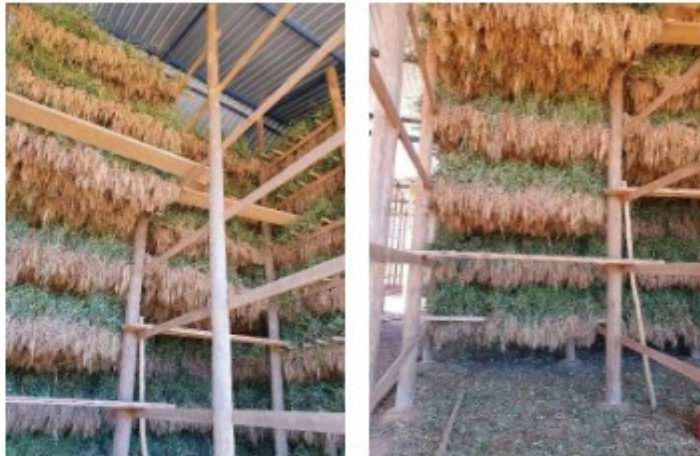
Fotos 3 e 4 – Sistema de secagem do alho, sem proteção contra queda ou uso de cinto de segurança.
