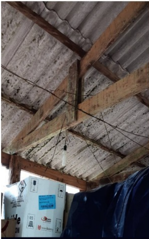
Foto 11: Instalações elétricas irregulares – risco de choques e incêndios
