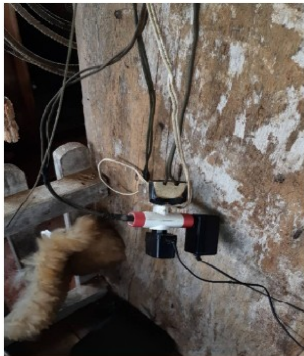
Foto 10: Instalações elétricas irregulares – risco de choques e incêndios
