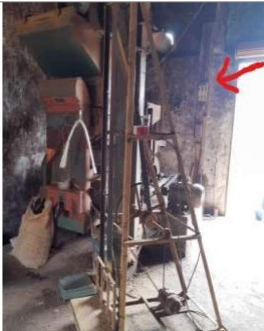
Quadro de energia, com chave tipo faca e lombard, instalado ao lado da máquina de ensacamento do café.
