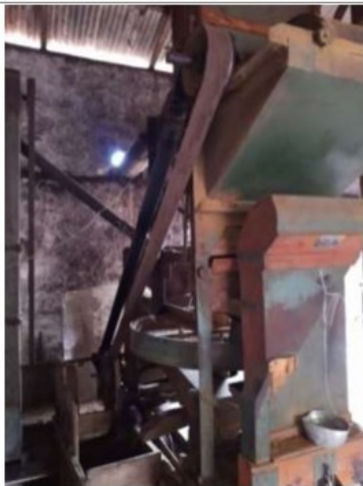
Máquina utilizada no ensaque, sem proteção das transmissões de força
