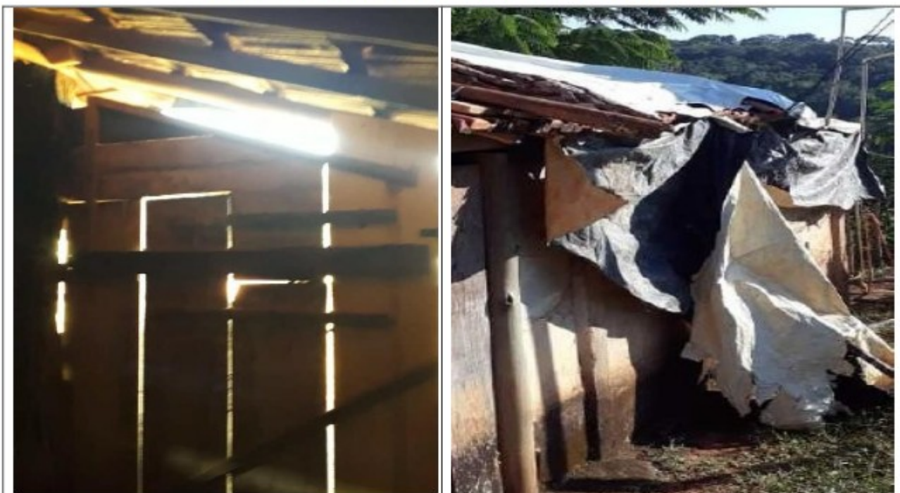
Figura 3: aberturas nas paredes e lonas sobre o telhado colocada pelo empregado para diminuir as goteiras das chuvas
