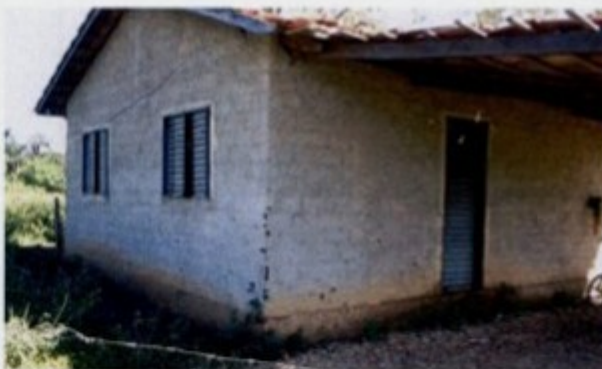
Moradia sem paredes caiadas
