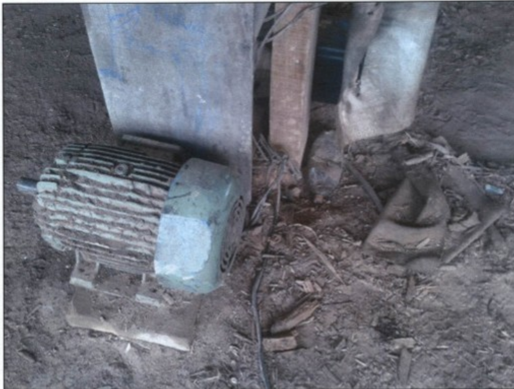
Condutor de alimentação elétrica desprotegido.
