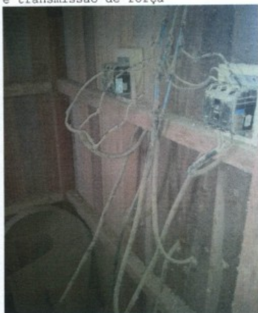
Instalação elétrica em desacordo com a NR-12
