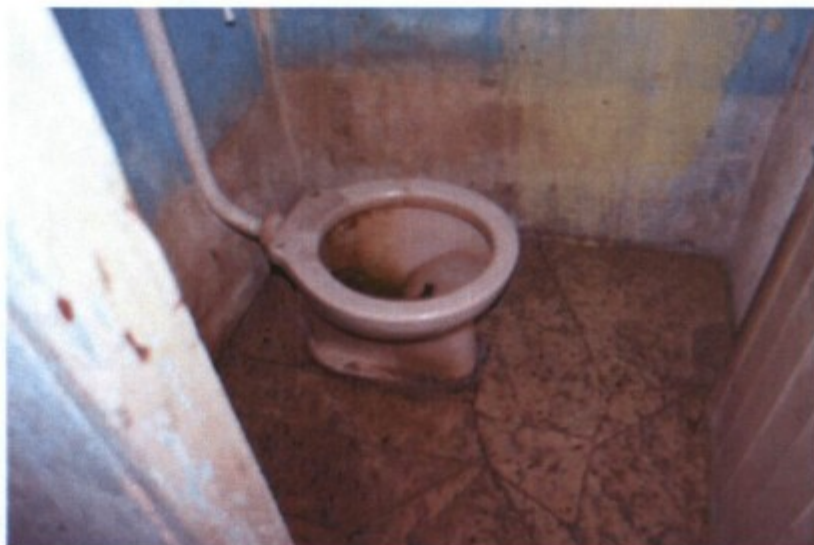
Vaso sanitário danificado, sem tampa, sem cesto de lixo, em péssimas condições de higiene, o único disponibilizado na oficina de [REDACTED] - 14/03/2014
