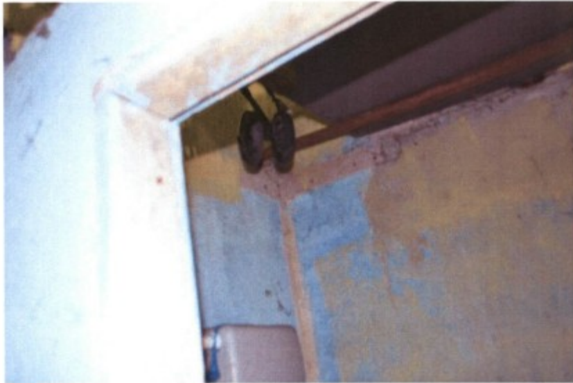
Teto das instalações sanitárias em aberto, comprometendo com a privacidade dos trabalhadores que utilizam o vaso sanitário – 14/03/2014
