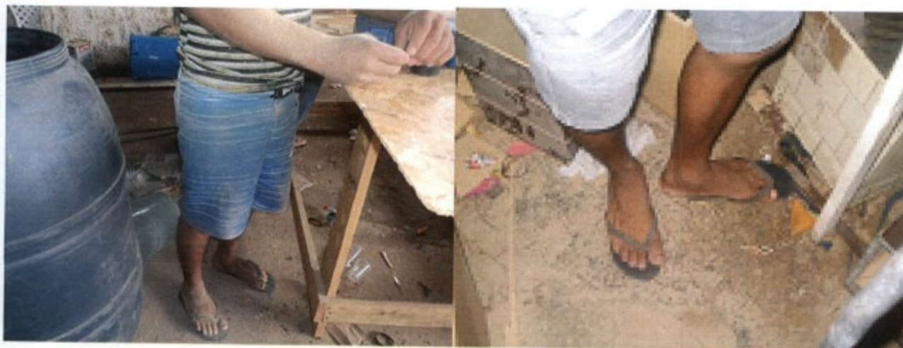
Fotos 1 e 2 – Trabalhadores destituídos de calçado de segurança (uso de chinelas “havaianas”).
