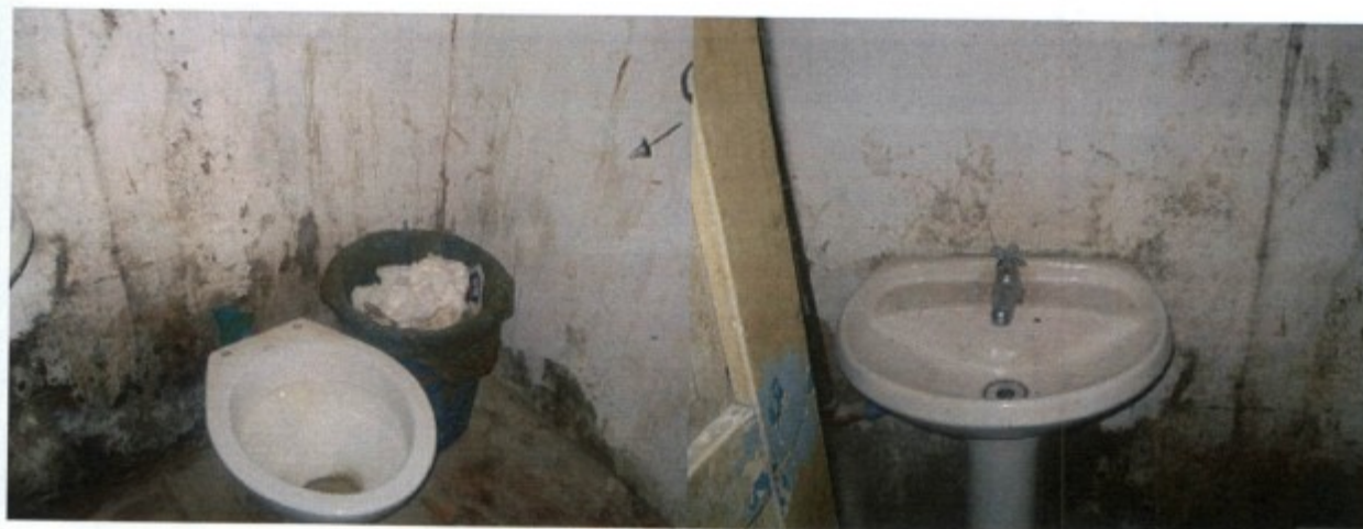
Fotos 7 e 8 – Instalações sanitárias em desacordo com as normas regulamentadoras (ausência de tampa em recipiente de coleta de papéis servidos e ausência de material para enxugo e lavagem das mãos).
