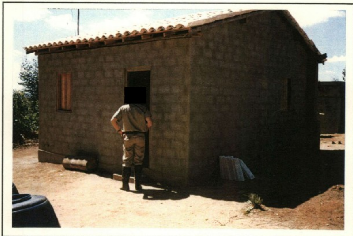
CARVOARIA ONDE OS TRABALHADORES SAÍRAM CORRENDO PELO MATO QUANDO DA CHEGADA DA FISCALIZAÇÃO.
