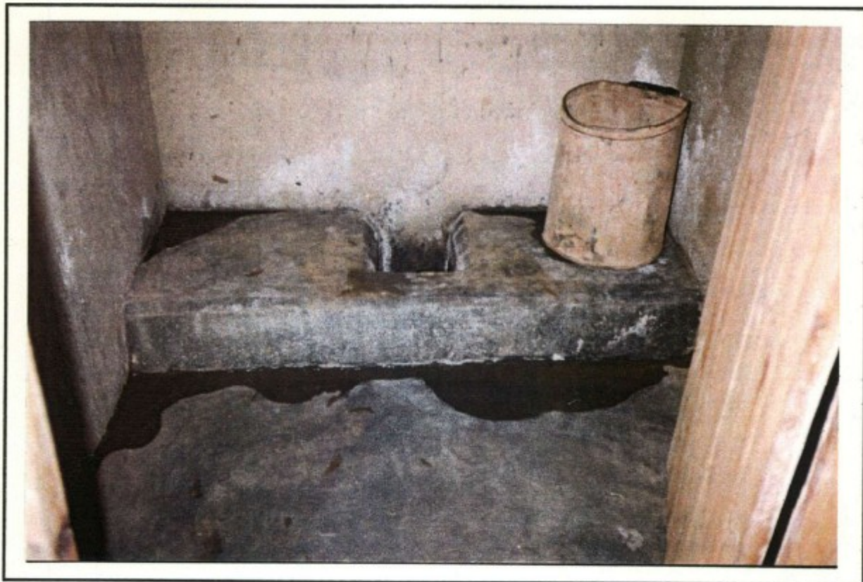
INSTALAÇÃO SANITÁRIA COM FOSSA NEGRA NA CARVOARIA DO EMPREITEIRO ██████████
