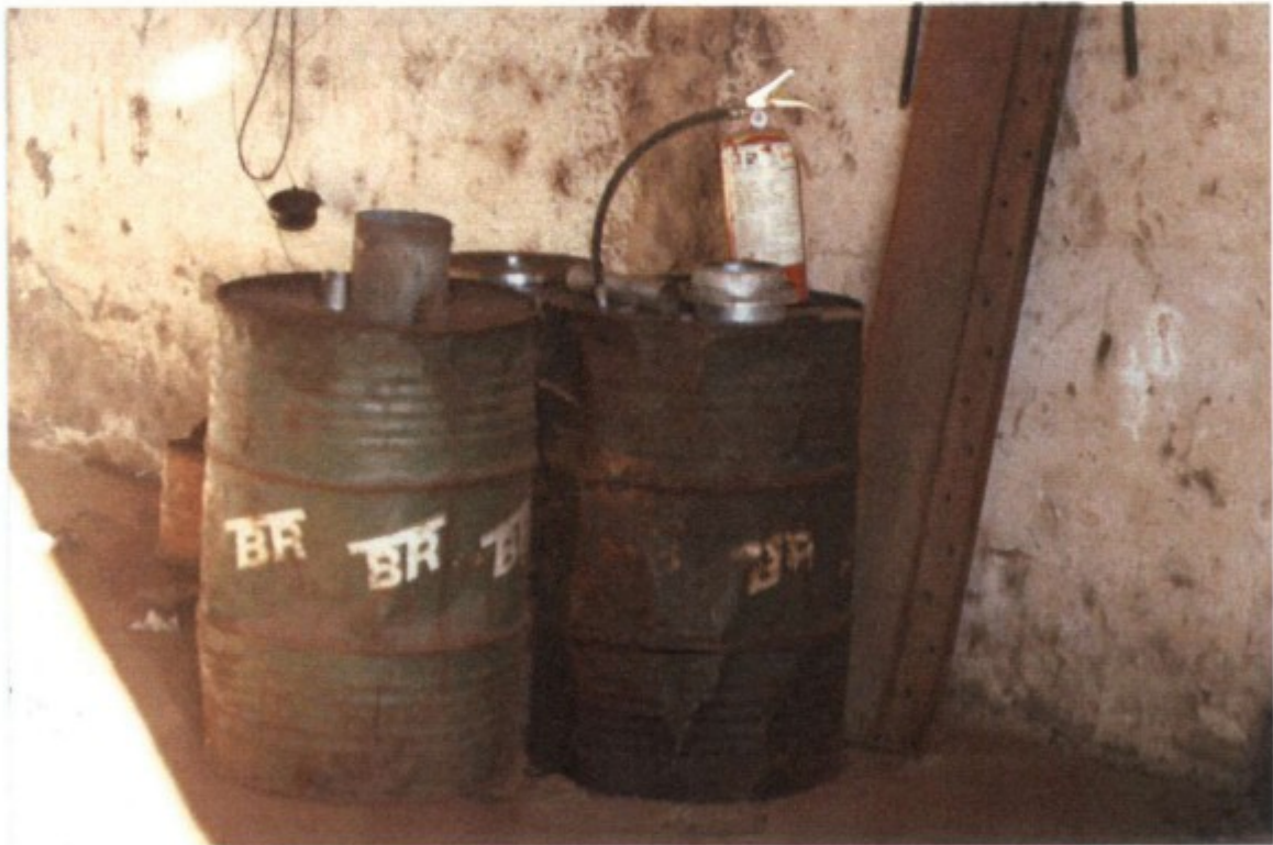
Foto 10: Extintores em posição inadequada e sem carga.
