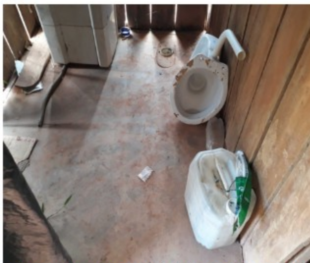
Local onde estava o vaso sanitário sem estar instalado.
