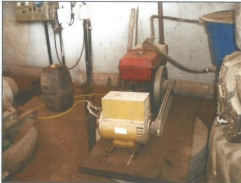
Fotos: Transmissão de força do gerador de eletricidade desprotegida.
