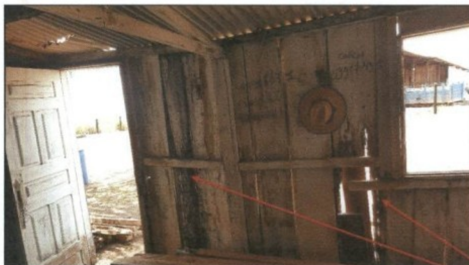
Foto: Parede interna do galpão de agrotóxicos, que era de madeira e possuía diversos pontos deteriorados.
